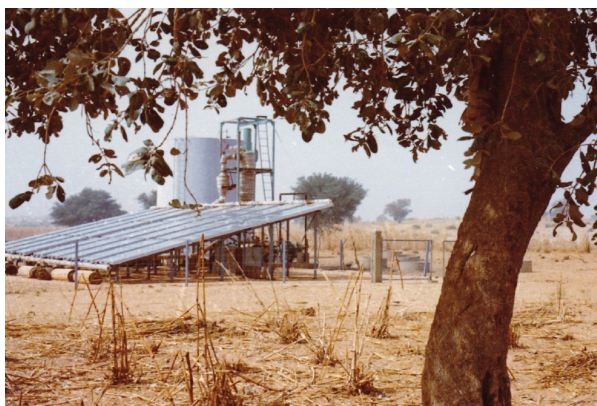
Pompe solaire thermique de Bossey Bangou (1969).
